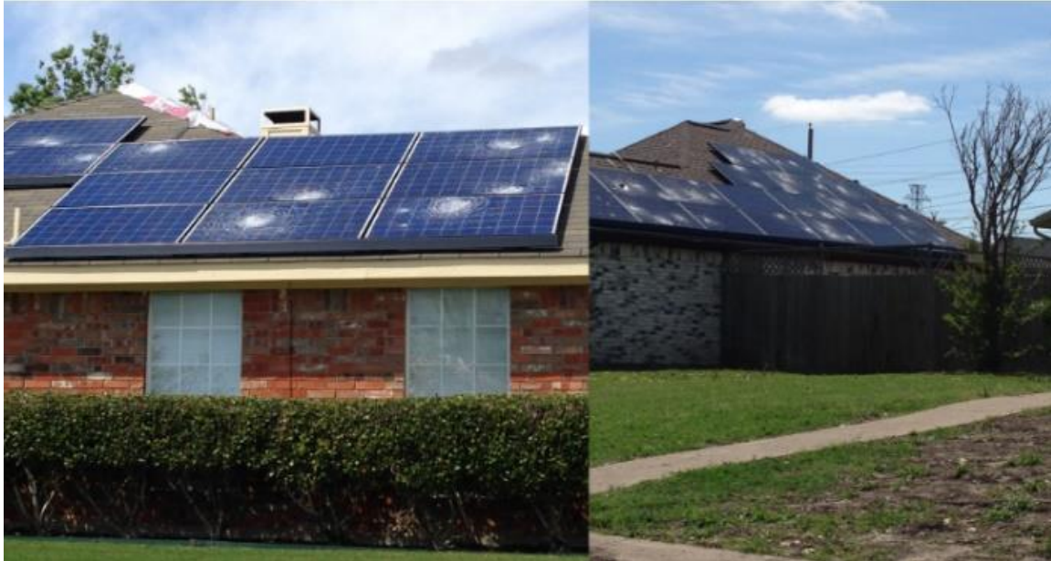
图 3-36: 冰雹损坏住宅的太阳能电池板。 216
