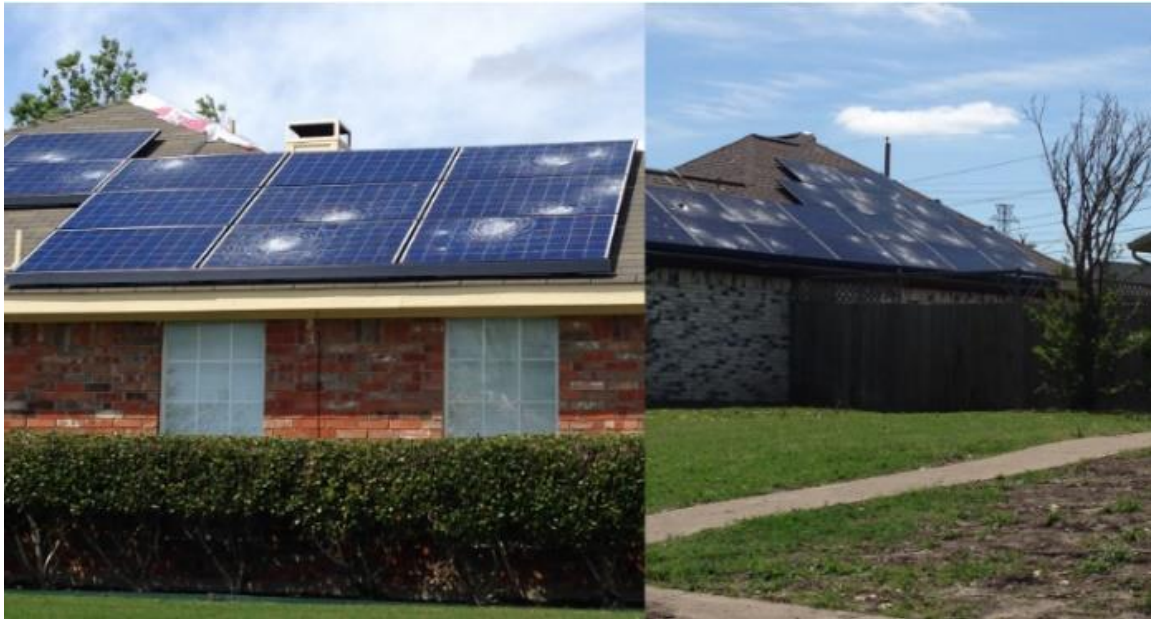
Figura 2-44: Daños por granizo a paneles solares residenciales. 212
