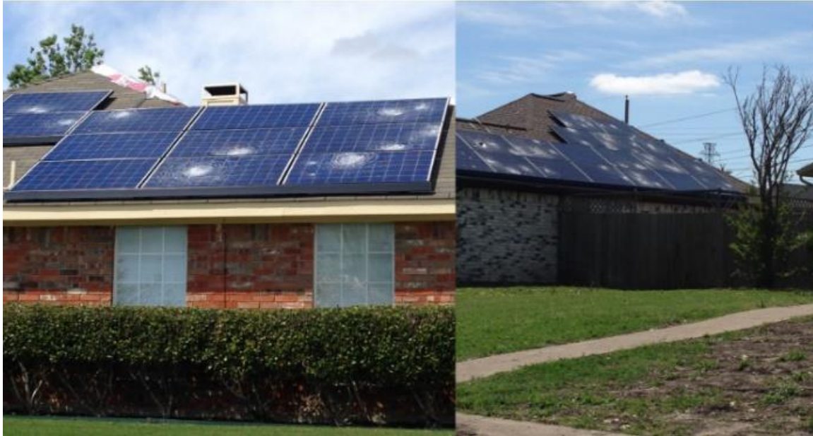
Figura 3-46: Daños por granizo a paneles solares residenciales. 216
